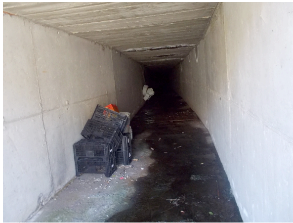
Foto 3. Fotografía de las cajas de plástico y otros en el interior del encauzamiento.
